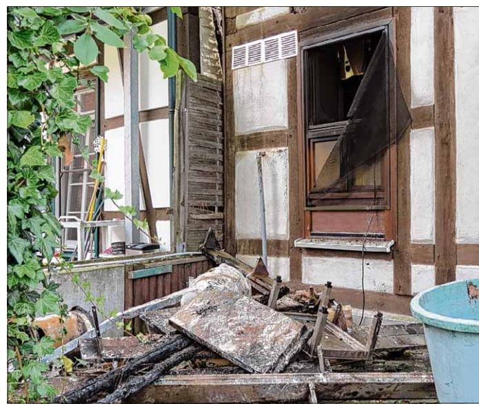
Schutt und ein kaputtes Fenster erinnerten am nächsten Morgen an den Brand im Eiscafé. Foto: Roberto Abramowski
